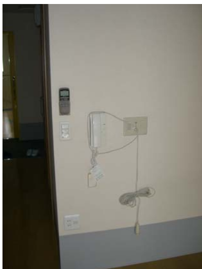
緊急警報装置
