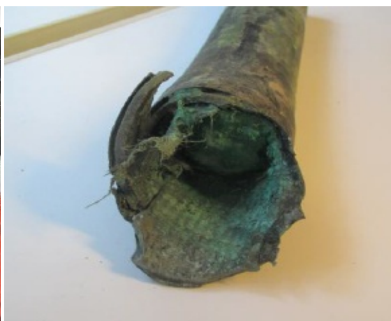
海水により腐食したケーブル (出典) MTA ホームページより
