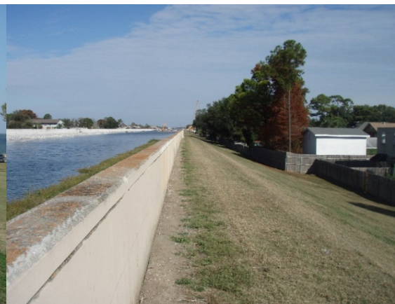
決壊した運河（右側の住宅街が運河よりも低い）
