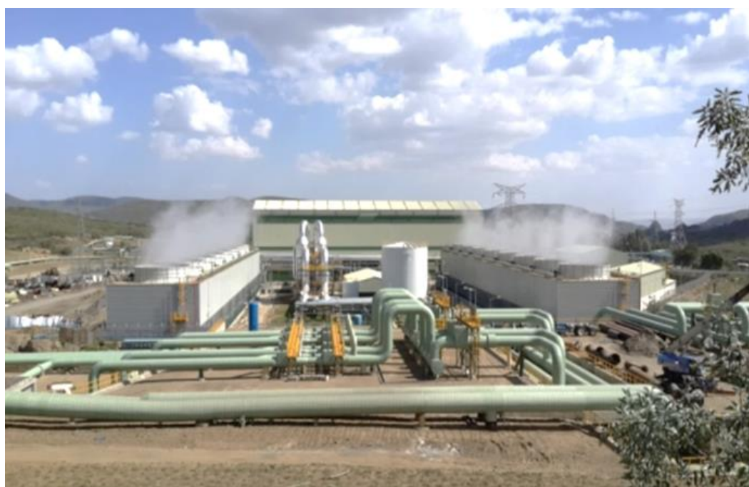
オルカリア I 4・5 号機地熱発電所
