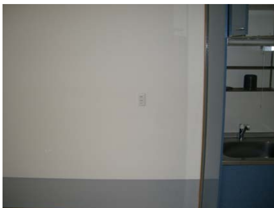
車椅子に配慮されたコンセント
