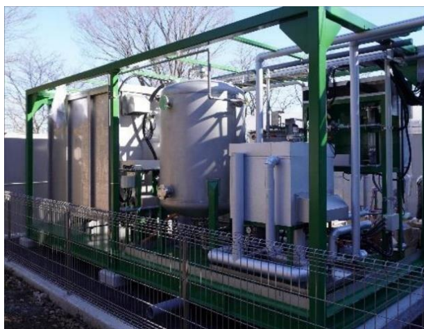
<メタン発酵バイオガス発電設備>
