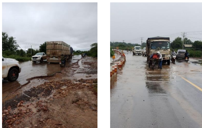
写真1 豪雨による道路損傷
