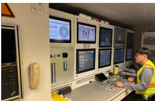
(制御室の様子)
